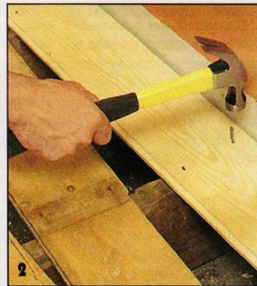
Перед закреплением первой доски нужно не забыть оставить зазор между ней и стеной.
